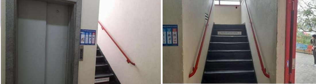
Fotografias 7 e 8 - Elevador e acesso a escadas com corrimão Polo Aricanduva
